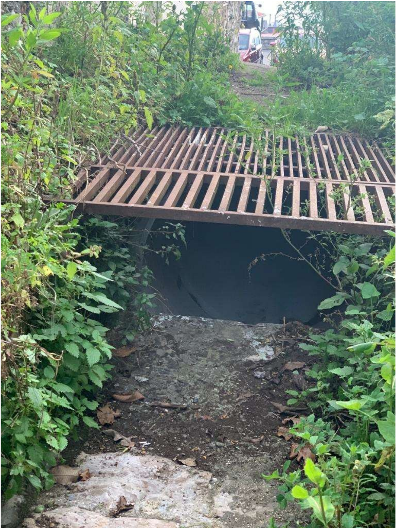
Figura 7 - imbocco del secondo tratto tombato, è chiaramente visibile la tubazione di diametro pari a 800m
