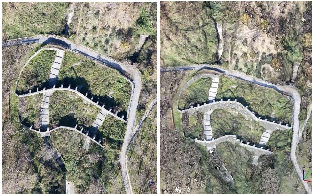
Figura 8 - vasche realizzate alla confluenza di due incisioni vallive, a sinistra foto aerea e a destra modello 3D. Altre opere consistono nell'aver realizzato difese spondali in gabbionate, in diversi tratti della cartografia allegata.
