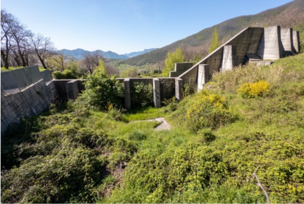
Vasche per difesa da debris flow
