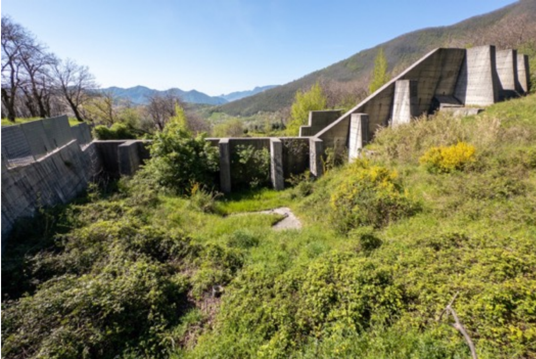
Vasche per difesa da debris flow
